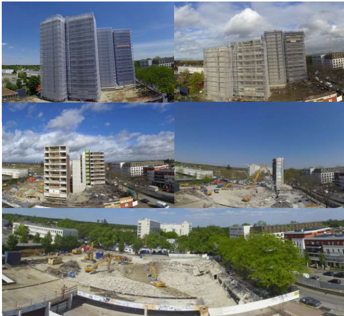
L'exemple ci-dessus est un timelapse d'une durée de 18 mois montrant la démolition par écrêtage de deux tours d'immeubles situés à Aulnay-Sous-Bois en Ile-de-France.
